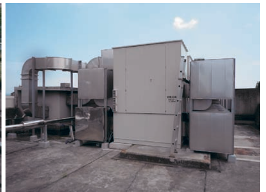
改修後の新館屋上2F・3F系統全熱交換器 周り(平成22年7月撮影)
