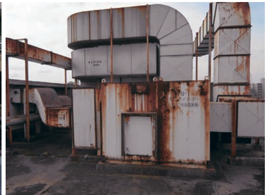
改修前の新館屋上2F・3F系統全熱交換器 周り(平成19年4月撮影)
