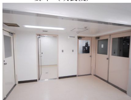
135 室 & 136 室 (IVIS 機器室)
